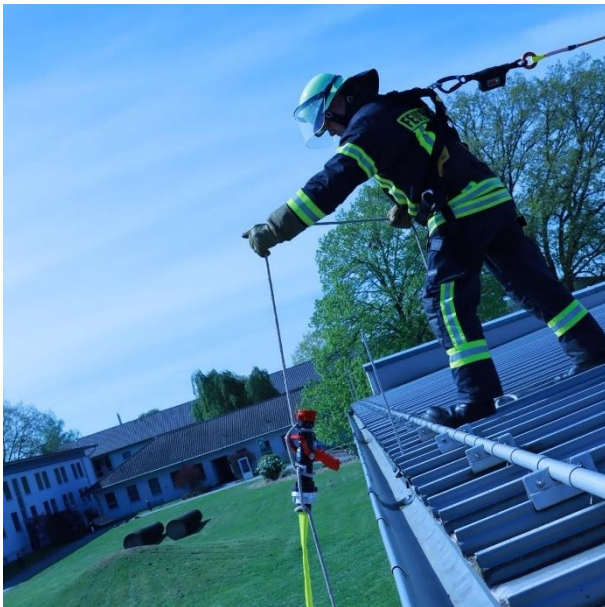
18-1 Feuerwehrangehöriger im absturzgefährdeten Bereich beim Hochziehen von Ausrüstung
