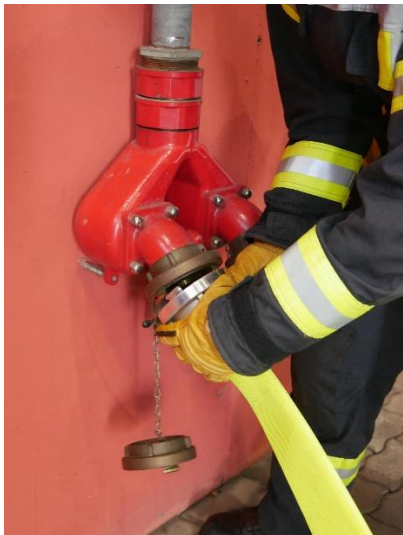
4.5-3 Eine Einsatzkraft kuppelt einen Schlauch an die Festkupplung einer Löschwassereinspeisung
